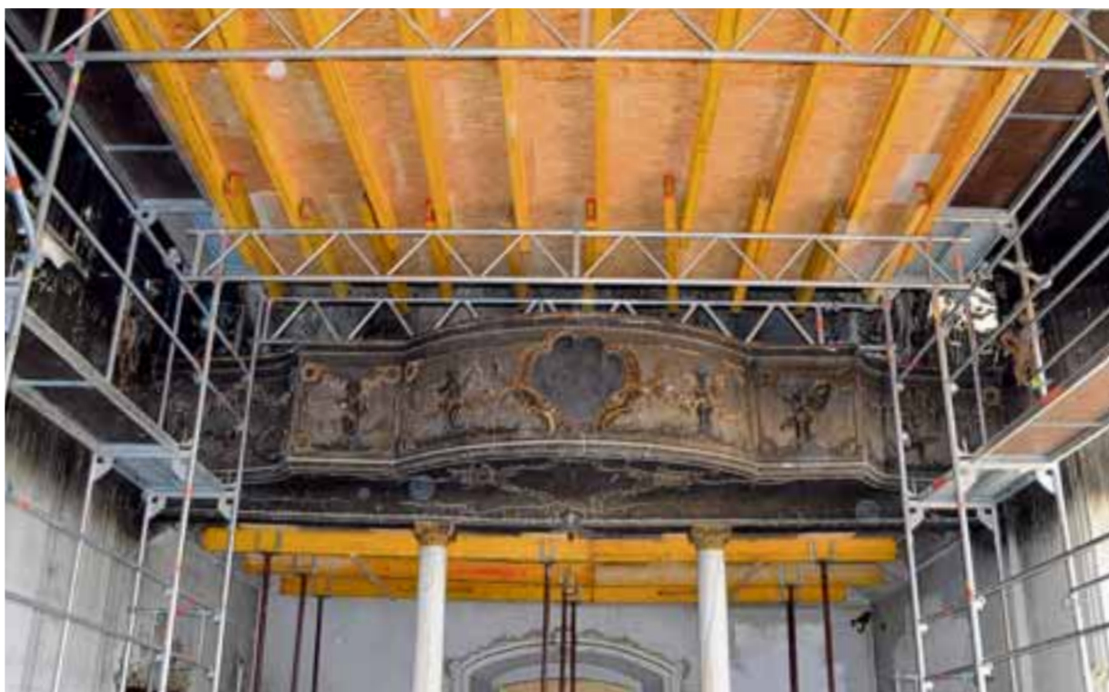
Die Margaretenkapelle wurde bei dem Brand besonders schwer beschädigt. Mittlerweile wurde ein Gerüst aufgebaut, um die Statik zu sichern.
